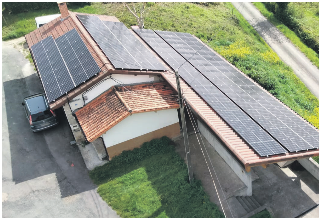
Soxoko instalazio fotovoltaikoa. Aiaraldea.eus
